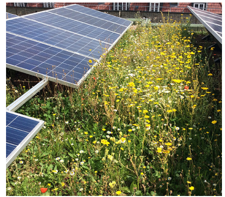
Zonnepanelen en beplanting voor daken uit het zicht ©Bauder. Clapham Par
